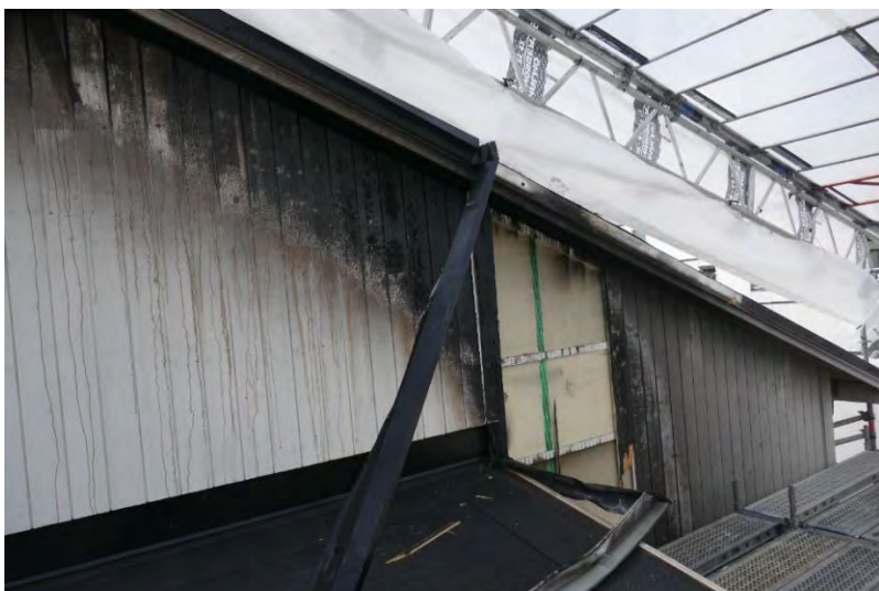
Figur 12. Brandskador längs med takfoten.
