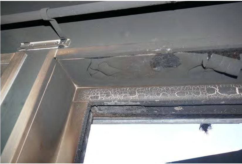
Figur 9. Brandskador invändigt på karmen till balkongdörren.
