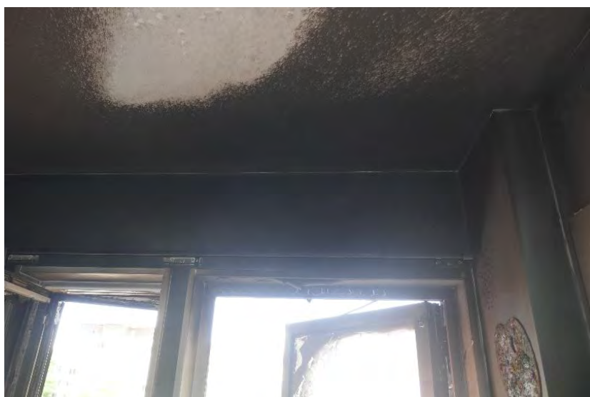
Figur 8. Sotskador i tak.
